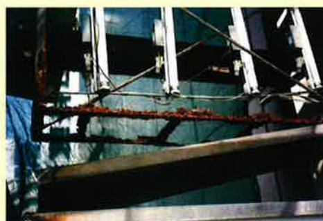
↑ 高所に設置された看板の 底部が脱落
