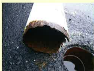
↑ 看板を支える柱の根元が 錆びて倒壊
