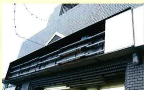
↑ 店舗の壁に設置された看板 の板面が落下
